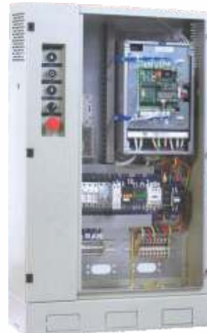
TỦ ĐIỆN NGOẠI NHẬP STEP - THÁI LAN
